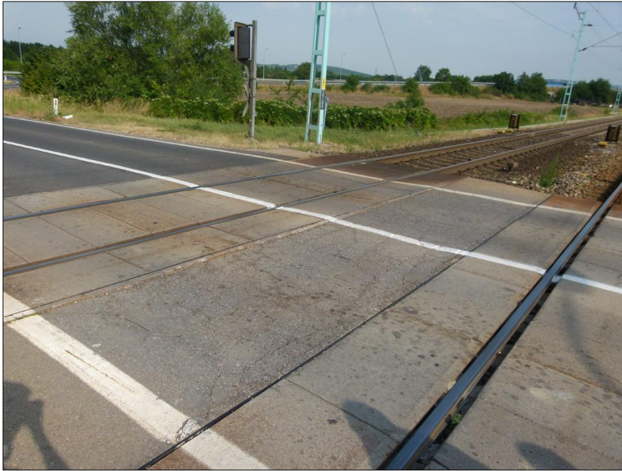
LXVIII. ábra: EK101,529-es vasúti átjáró, megsüllyedt útburkolat 2
