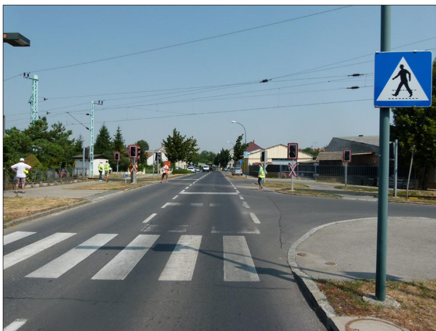
21. ábra: Az AT04-es vasúti átjáró, 1. irány: a veszélyes hely előjelzésére szolgáló vonalak megkoptak
