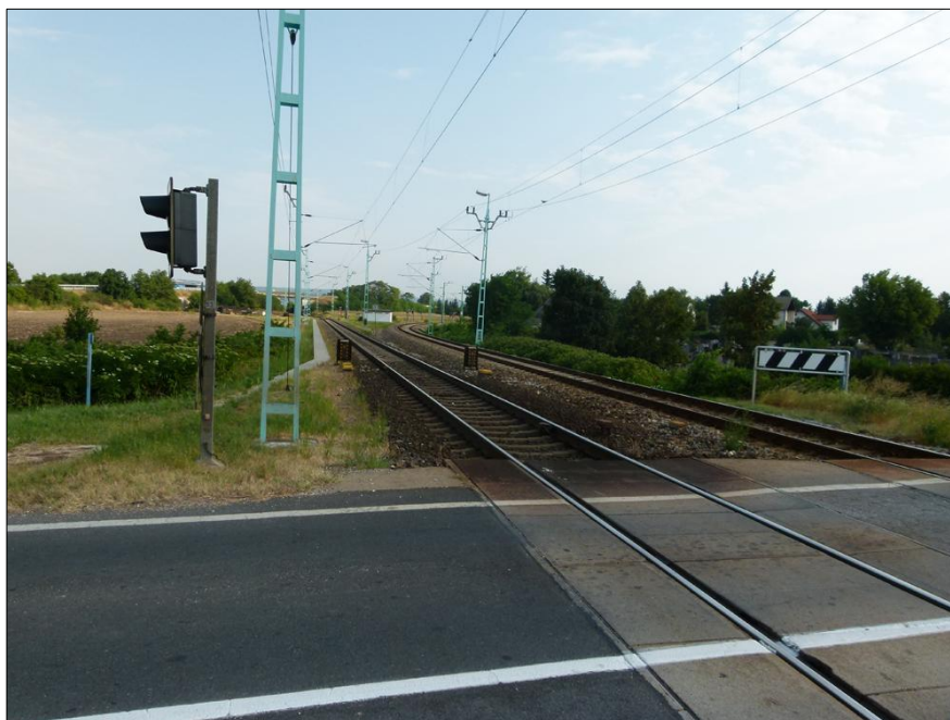
LXVII. ábra: EK101,529-es vasúti átjáró, megsüllyedt útburkolat 1
