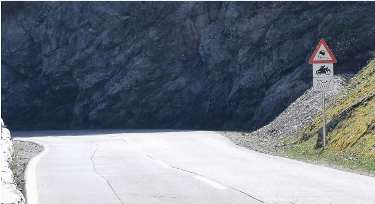
ABBILDUNG 77: L246 Hahntennjochstraße km 8,2 bis 8,3, Achtung Schleudergefahr
