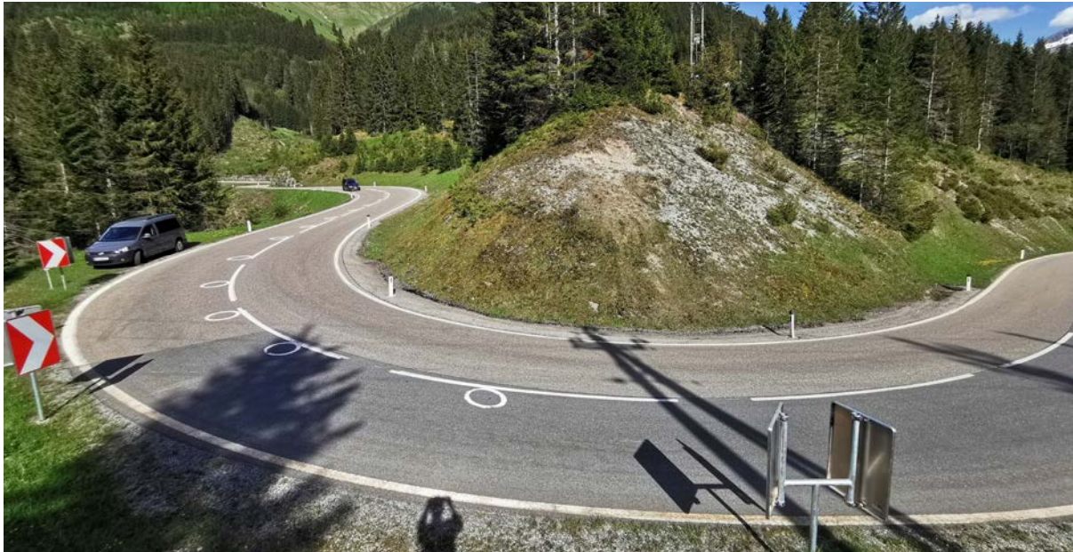
ABBILDUNG 59: L21 Berwang-Namloser Straße km 10,0, Foto mit Ellipsenmarkierungen
