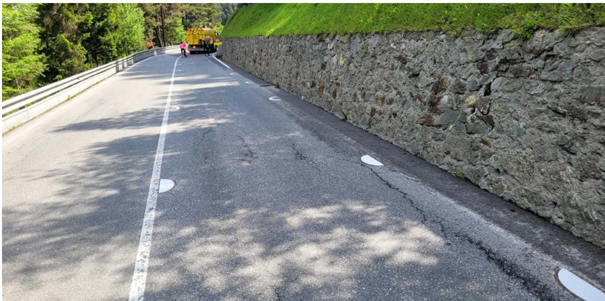
ABBILDUNG 33: B182, Brennerstraße, km 10,65, nach der Intervention 2023
