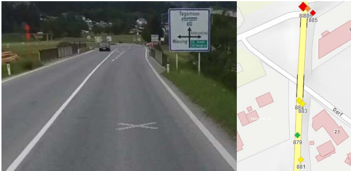
ABBILDUNG 26: Vorheriger Bericht. Sichtbehinderung durch einen Wegweiser, Achenseestraße km 1,0 (Google Street View und Unfallkarte aus Crashbox)
